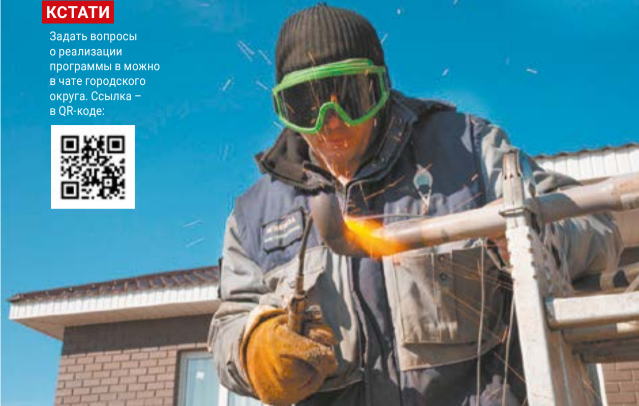
ФОТО: АО «МОСОБЛГАЗ»
